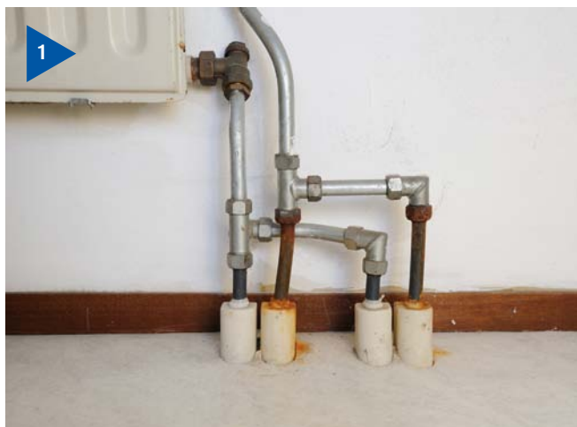
OUDE SITUATIE AAN RADIATORZIJDE MET ZICHTBARE ROESTVORMING DOOR DIFFUSIEPROBLEEMEN.
