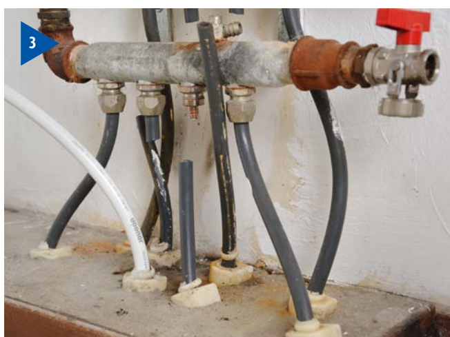
OUDE SITUATIE ONDER DE DEUR DIFFUSIE AANGETASTE STAAL VERDELER AAN CV ZIJDE. HIER WORDT DE EERSTE LEIDING VANAF DE RADIATORZIJDE DOOR DE MANTEL GETROKKEN.
